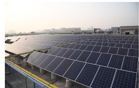
啟新廠屋頂太陽能發電站
