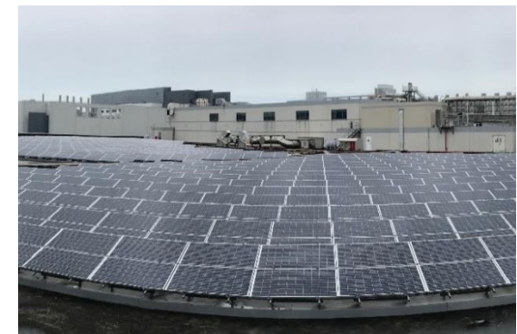
力行廠屋頂太陽能發電站
