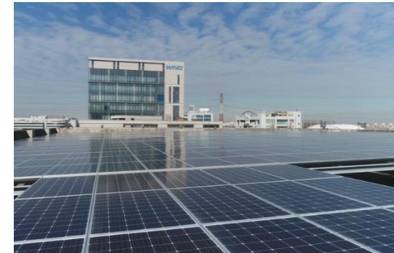
臺灣總部停車棟屋頂太陽能發電站
