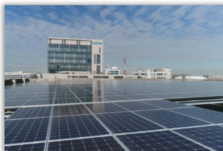
總部停車棟屋頂太陽能發電站
