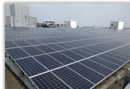
南科廠屋頂太陽能發電站
