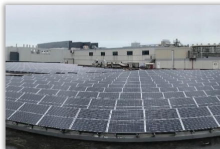
力行廠屋頂太陽能發電站
