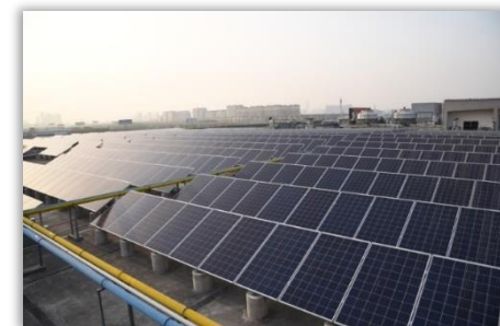
啓新廠屋頂太陽能發電站
